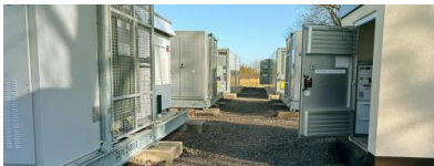
Der Batteriespeicher von Tauber Energy in Waltershausen (Thüringen). Quelle: Tauber Energy
