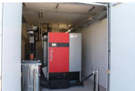
Einer der beiden Pelletkessel in der neuen Energiezentrale Wullenstetten der SWU Quelle: E&M / Heidi Roider
