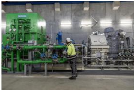
Ein Elektriker bei der Inspektion des Abwärmekraftwerks
