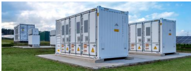
Batteriespeicher. Quelle: Baywa Re
