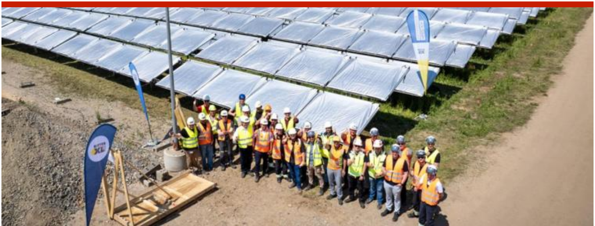
Das Kollektorfeld Solarthermie Lausen. Quelle: Stadtwerke Leipzig
