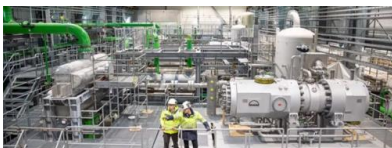
Großwärmepumpe mit Meerwasser im dänischen Ejsberg mit 60 MW Leistung. Quelle: MAN Solutions
