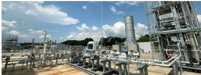
Wasserstoffspeicher von EWE. Quelle: EWE / Nadine Auras
