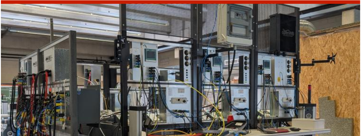
Der Versuchsstand im Projekt "GridMaximiser" umfasste Wallboxen, Wechselrichter, Batterien sowie Mess- und Steuereinheiten. Quelle: TH Köln / Henrike Klehr
