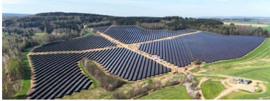
Solarpark Gornau. Quelle: Goldbeck Solar
