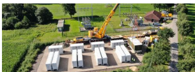
Aktuelles Batteriespeicherprojekt von Terra One in Ahlerstedt nahe Stade. Quelle: be stored
