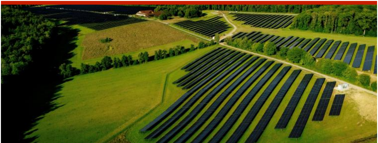
Neuer EnBW-Solarpark im Landkreis Heilbronn mit Hybridbatteriespeicher. Quelle: EnBW / Paul Gärtner
