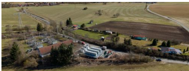
Die 10-MW-Batterie steht in Königsee (Thüringen). Quelle: Second Foundation
