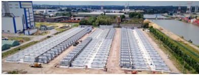
Der Großspeicher in Belgien soll bis Ende 2025 fertig installiert sein. Quelle: Sungrow / Engie
