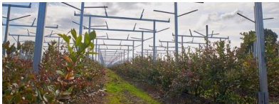
Die Ständer über den Heidelbeeren tragen künftig PV-Paneele. Quelle: NRW Energy 4 Climate
