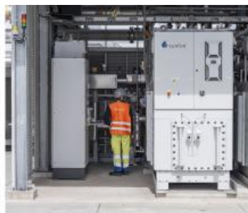
SOEC-Elektrolyseur von Sunfire wurde in Rotterdam installiert
