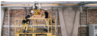
Per Pantografen werden die Busse in Stuttgart künftig geladen. Quelle: Omexom Deutschland
