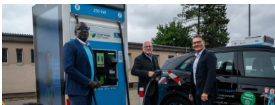
Der Schnellladehub in Zuffenhausen ist in Betrieb. Quelle: Stadtwerke Stuttgart
