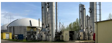
Biomethanaufbereitungsanlage am Standort Dargun wechselt den Besitzer. Quelle: BALANCE
