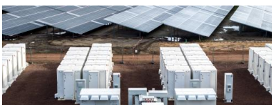
Der Solarpark in Zerbst mit dem Batteriespeicher im Vordergrund. Quelle: Statkraft
