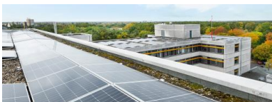
Die Photovoltaikanlage auf dem Waldkrankenhaus in Berlin-Spandau Quelle: Leo Seidel
