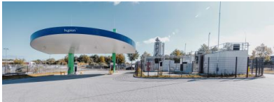
Die Hypion Wasserstofftankstelle in Neumünster wird von MB Energy betrieben. Quelle: MB Energy
