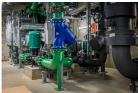
Die Energiezentrale bei Toyota
