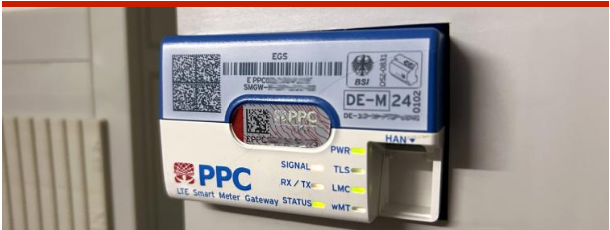
Smart Meter Gateway von PPC. Quelle: Katia Meyer-Tien
