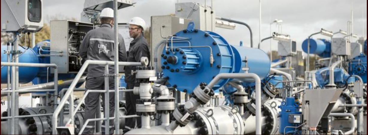
Erdgasspeicher Etzel in Niedersachsen. Quelle: Uniper
