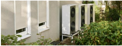
Das Quartier "Untere Lichtenplatzer" in Wuppertal wurde mit Wärmepumpen ausgestattet. Quelle Uwe Schinkel / gwg
