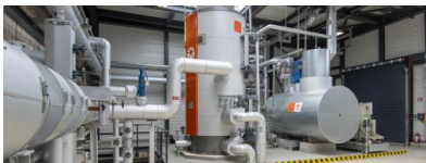
Elektrodenkessel im Chempark Dormagen. Quelle: Currenta
