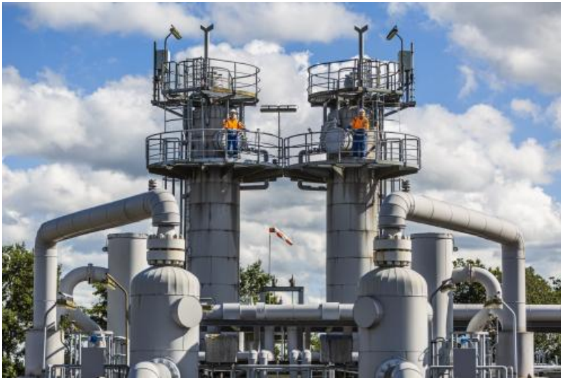
Der Erdgasspeicher Harsefeld in Niedersachsen.
