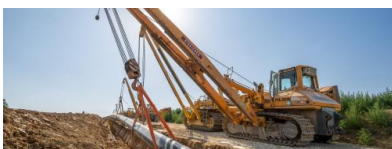
Seitenbaumraupen senken den Rohrstrang mit 70 Zentimetern Durchmesser ab. Quelle: Eckhart Matthäus /Bayernets
