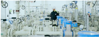
Verdichterstation in Radeland, Brandenburg. Quelle: NEL
