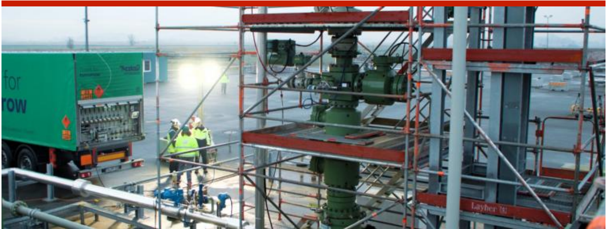
H2-Befüllung der H2CAST-Projektkaverne auf dem Kavernenverteilerplatz in Etzel. Quelle: Storag Etzel / Gasunie
