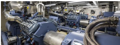
Wärmepumpenanlage, die Abwärme der Rechner der TU Dresden in Fernwärme umwandelt. Quelle: Martin Förster
