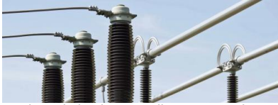
110-kV-Schaltanlage. Quelle: Bayernwerk
