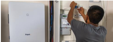
Installation eines Smart Meters. Quelle: Metrify
