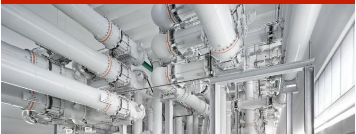
SF 6 -Schaltanlage im Umspannwerk Großgartach, nur wenige Kilometer vom Solvay-Werk in Bad Wimpfen entfernt. Quelle: Transnet BW
