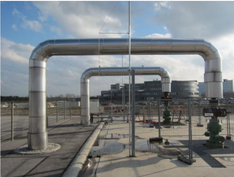
Über die Bohrungen wird in Unterföhring heißes Thermalwasser gefördert Quelle: Geovol
