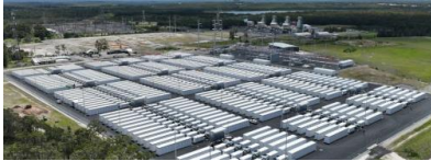
Waratah Super Battery bei Sydney. Quelle: Akaysha Energy
