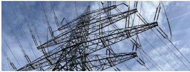
Freileitungen sollen beim Netzausbau wieder Vorrang haben. Quelle: Katia Meyer-Tien
