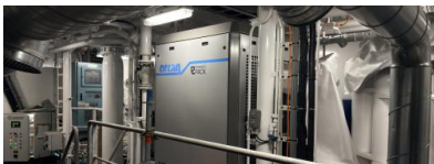
100-kW-ORC-Modul von Orcan Energy auf dem Frachter. Quelle: Orcan Energy
