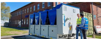
NKT-Werk für Mittelspannungskabel-Zubehör in Nordenham. Quelle: NKT
