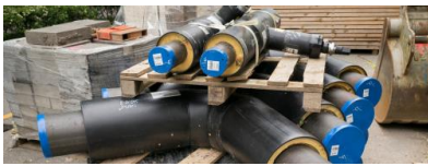
Wärmeleitungen. Quelle: Shutterstock / Richard Bradford
