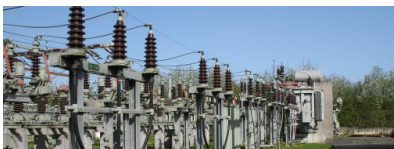
110-kV-Schaltanlage. Quelle: Günter Drewnitzky
