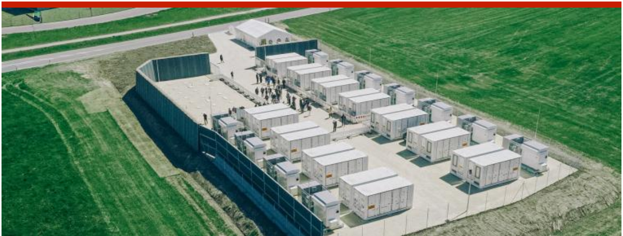
Der Batteriespeicher Balzhausen. Quelle: LVN
