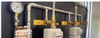
Installationstechnik ist ein zentrales Thema im Schulungszentrum Schirmitz. Quelle: Bayernwerk
