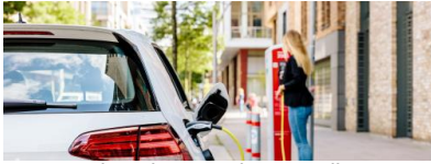
E-Auto-Ladesäule in Hamburg. Quelle: Hamburger Energienetze / Jakob Börner
