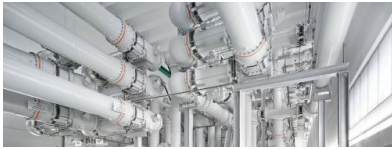
Gas-isolierte Schaltanlage im Umspannwerk Großgartach, ganz in der Nähe des SF6-Herstellers Solvay übrigens. Quelle: Transnet BW
