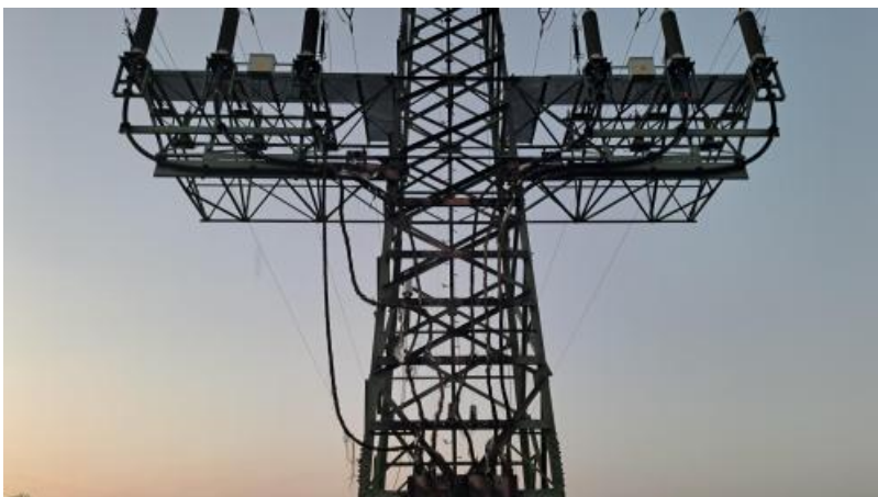
Beschädigte Leitungen an einem Mast bei Garching. Quelle: Bayernwerk
