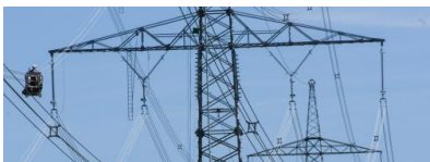
Arbeiten an einer 380-kV-Leitung von Tennet bei Erlangen (Bayern). Quelle: Günter Drewnitzky
