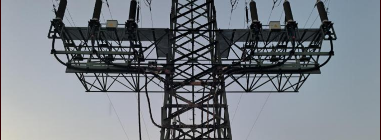
Ebenfalls durch Sabotage beschädigter Strommast bei Garching. Quelle: Bayernwerk
