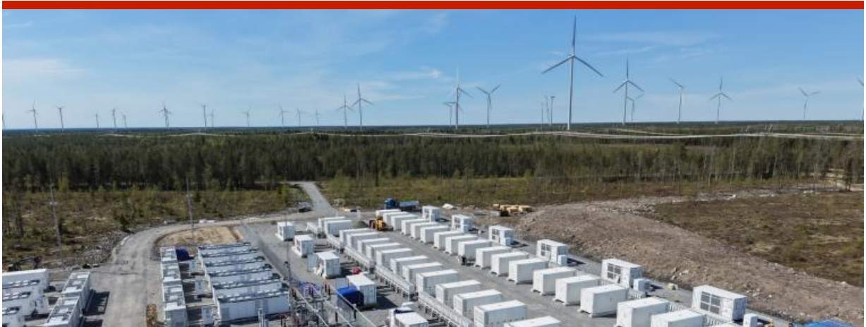
Batteriespeicher von FRV. Quelle: Fotowatio Renewable Ventures, S.L.U.
