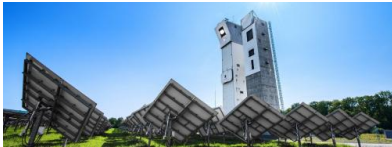
In Jülich betreibt der DLR eine in Europa einzigartige Großforschungsanlage für solare Bestrahlungstests. Quelle: DLR
