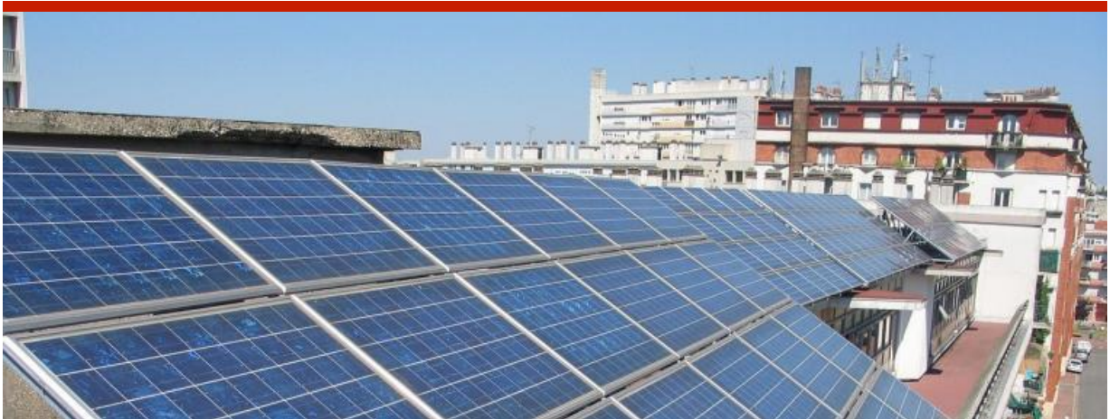
Dach-PV-Anlage. Quelle: Pixabay / cverkest
