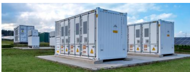
Batteriespeicher. Quelle: Baywa Re
