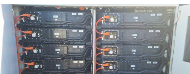
Die Lithium-Ionen-Batterien im Batteriecontainer. Quelle: EnBW / Alexander Vogel
