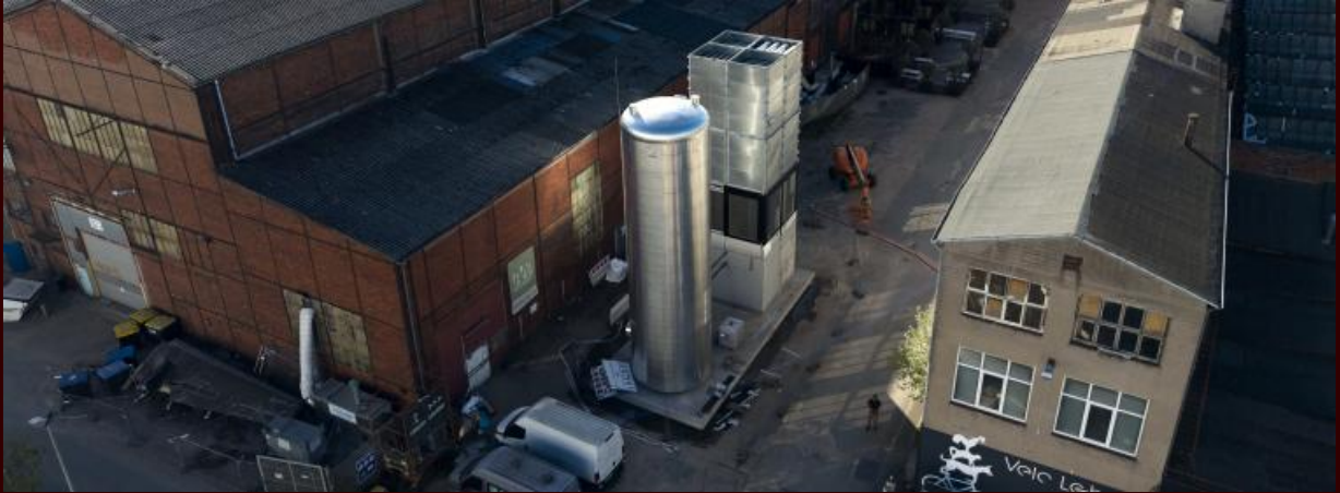
Der Klimaturm mit Wärmespeicher in Bremen. Quelle: Hauke Dressler
