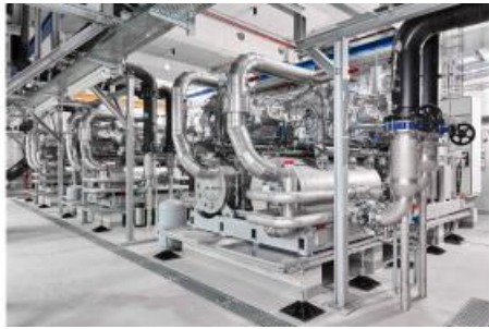
Blick ins Innere der innovativen KWK-Anlage Quelle: SW Gießen
