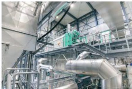
Innenansicht des neuen Biomasseheizwerks Dingolfing für den dortigen BMW-Standort Quelle: Schmidmeier Naturenergie
