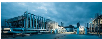
Erdgasspeicher Etzel. Quelle: Uniper
