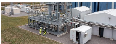
Die Gasaufbereitungsanlage des DBI - Gastechnologisches Institut gGmbH Freiberg im Energiepark Bad Lauchstädt. Quelle: Tom Schulze
