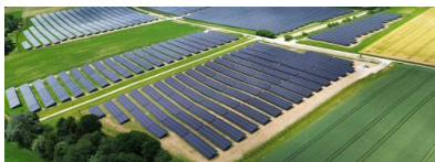
Der neue LEW-Solarpark "Am Ederhof" bei Daiting. Quelle: LEW / Anton Projects
