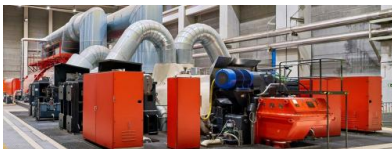
Blick in die Maschinenhalle von Block 4 am Kraftwerksstandort Staudinger. Quelle: Spie
