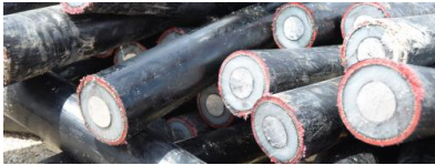
110-kV-Hochspannungskabel. Quelle: Katia Meyer-Tien
